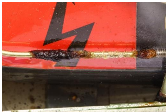
Figure 165 Cerclage métallique très corrodé © HE-Arc, N. Nydegger, 2019
