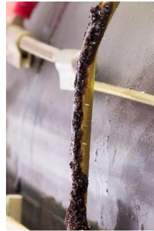
Figure 166 Autre partie du cerclage métallique corrodé © HE-Arc, N. Nydegger, 2019
